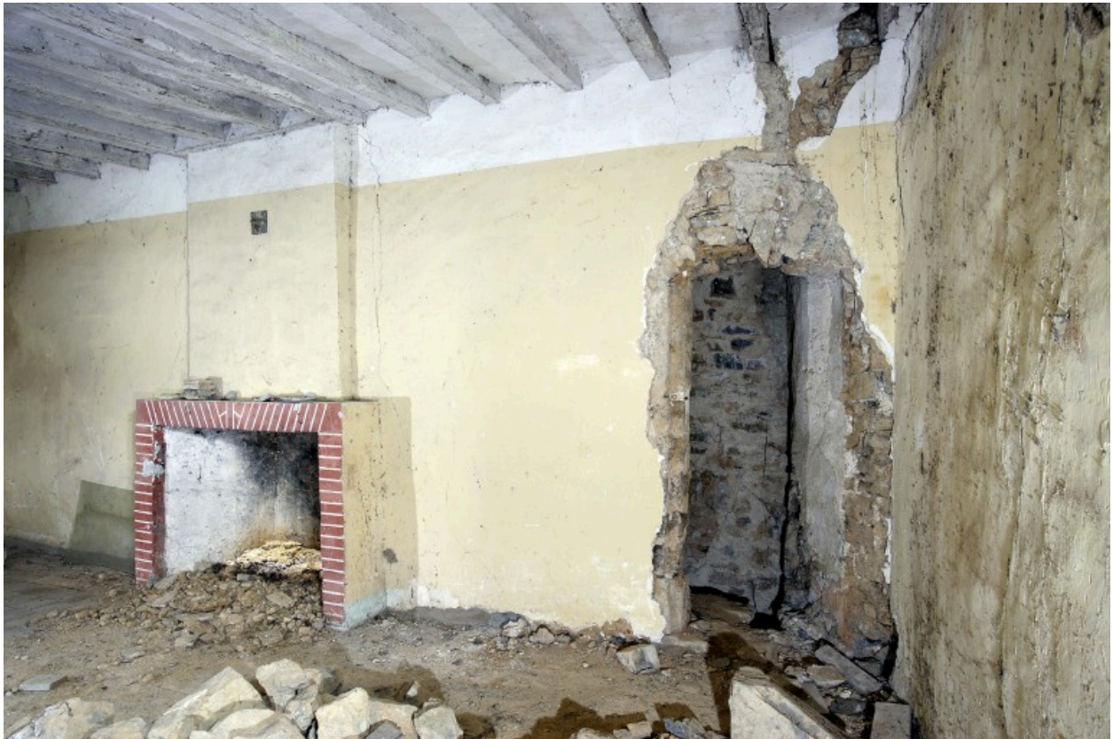
Le logis manorial, étage de la partie nord : le mur nord avec l'entrée des latrines.
