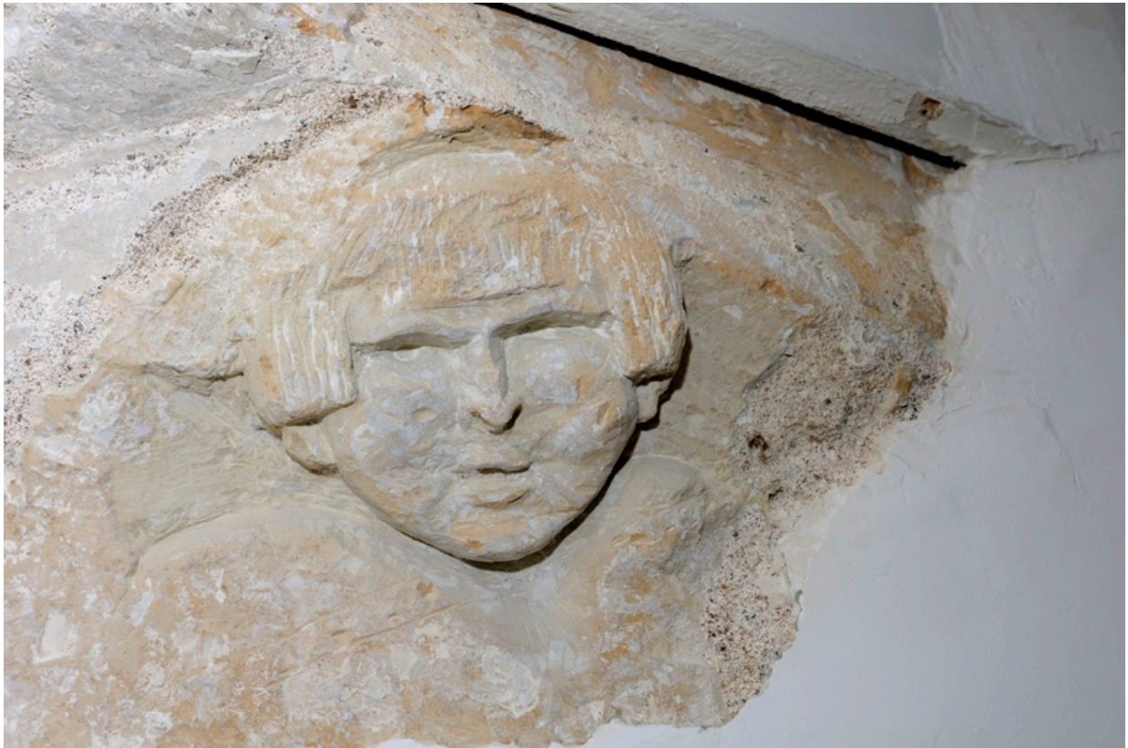
Ancienne chapelle nord (fin XVe siècle), RdC, mur sud : détail de la niche-crédence, avec voûte d'ogives bombée.
