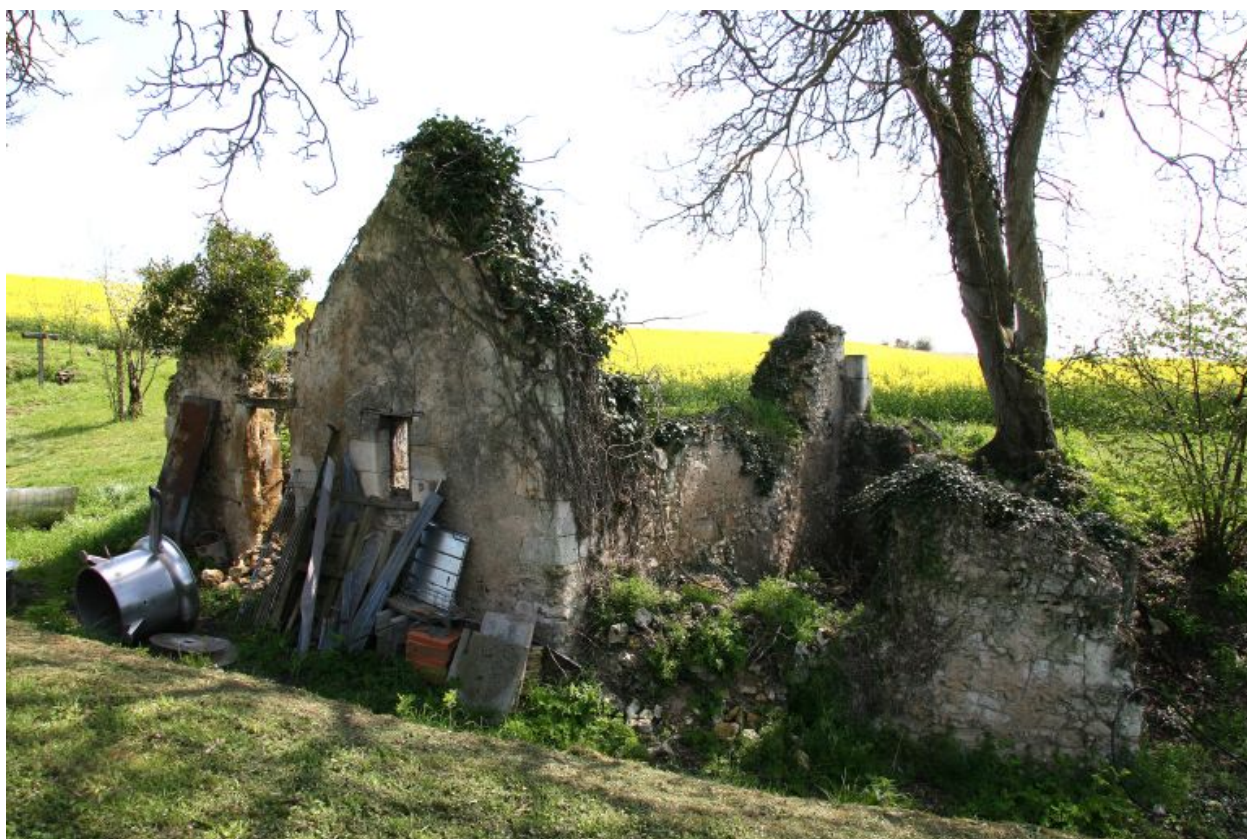
Maison 2 ruinée : la façade était dans le pignon et la cheminée sur goutterot.
