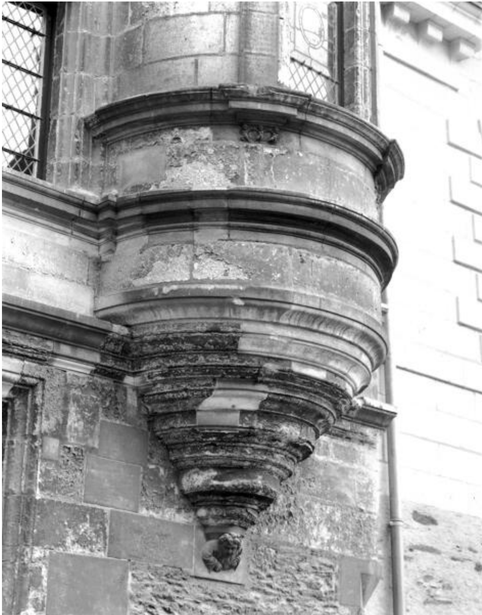
Corps de logis droit, élévation sur la rue de l'Espine, tourelle droite : partie inférieure.
