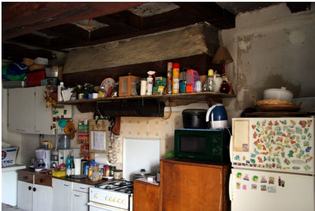
Cheminée de la cuisine.
