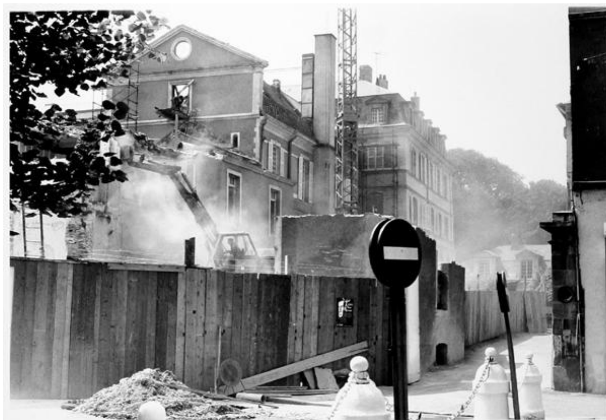
Aile ouest sur la cour d'honneur, pendant travaux : vue depuis le mail, au nord-ouest.
