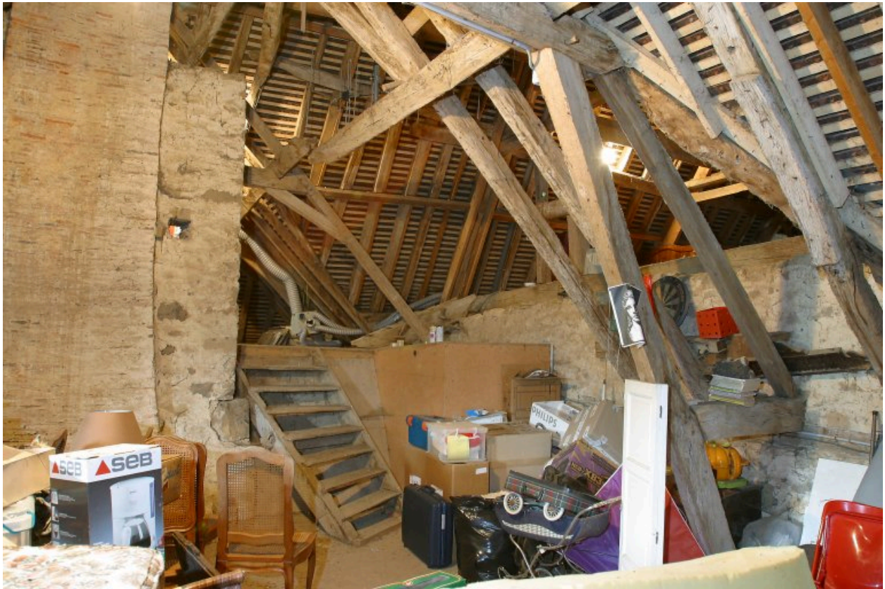
La partie centrale de la charpente du corps de bâtiment sud-ouest, vue depuis le sud. Au fond, à droite, le comble du corps de bâtiment nord-est.
