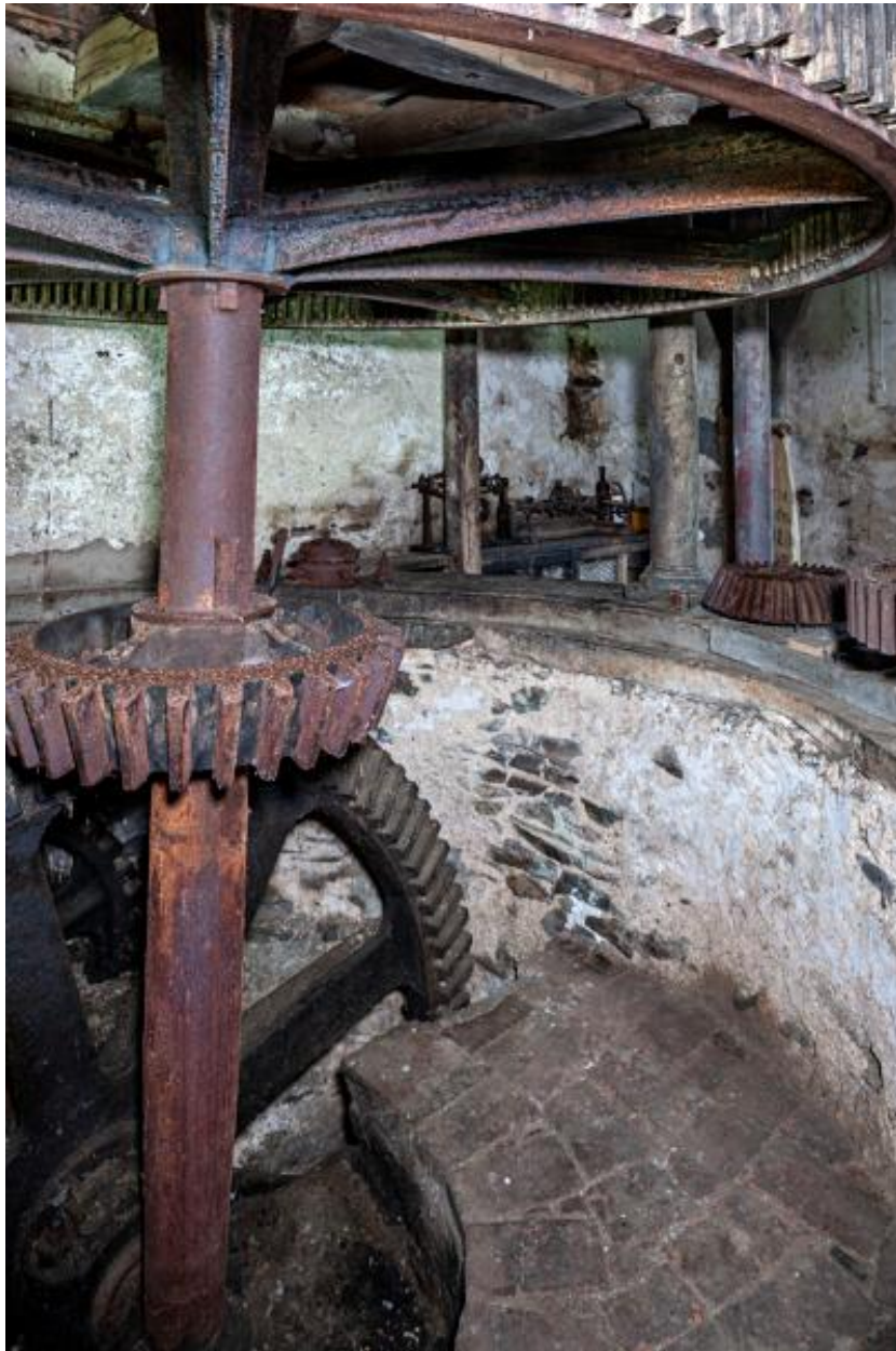
Rez-de-chaussée : vue rapprochée du système de transmission depuis le nord-ouest.
