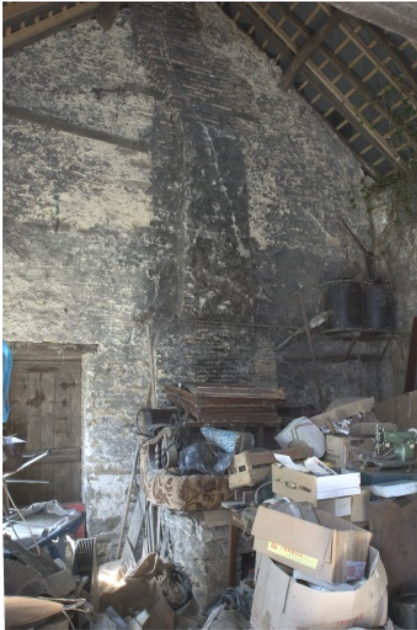
Intérieur du bâtiment de la forge : la forge vue depuis le nord.
