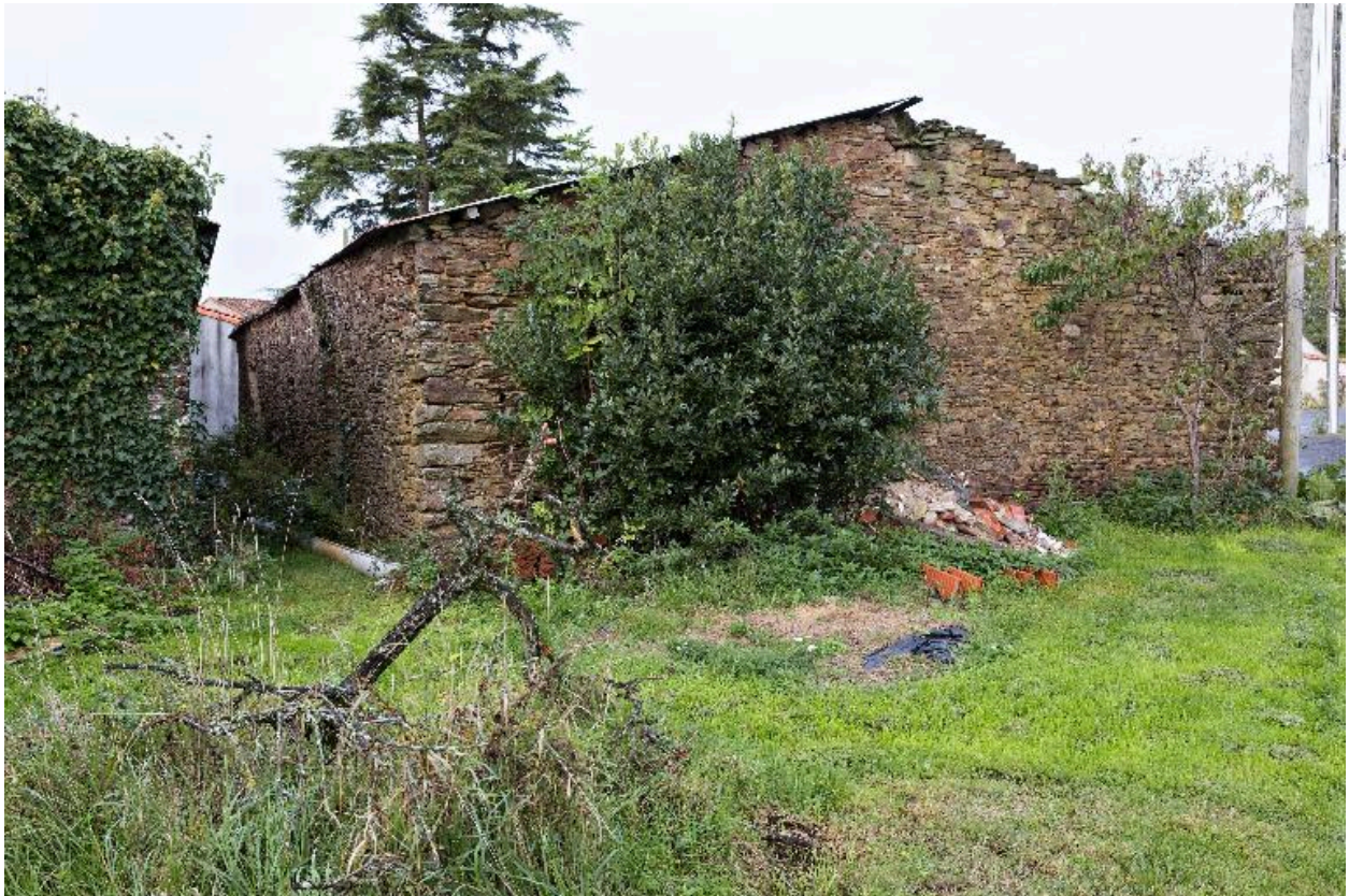
Mur pignon d'une ancienne habitation en bordure du commun de la Brégonnière, B01-278, cadastre 2018.
