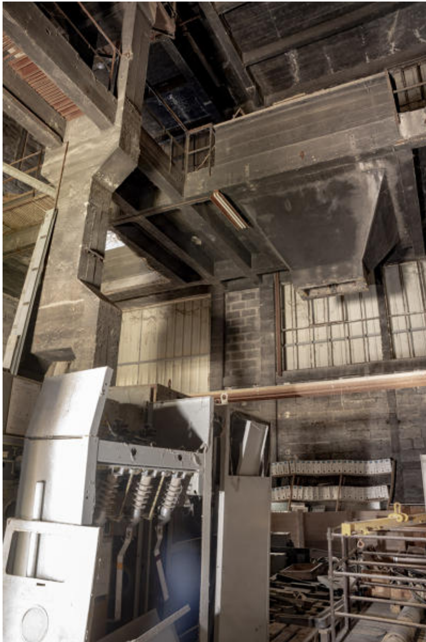
Intérieur de la chaufferie G de l'usine de papeterie.
