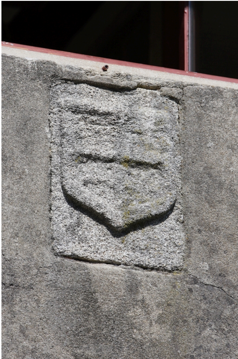
Logis. Façade sud. Détail de la pierre en remploi sculptée des armoiries des Le Boteuc.
