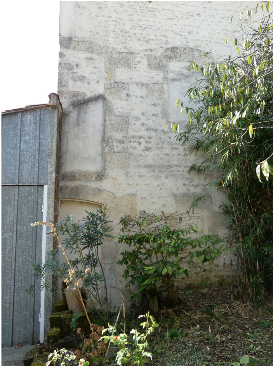
Baies murées sur le mur pignon du corps de bâtiment est.
