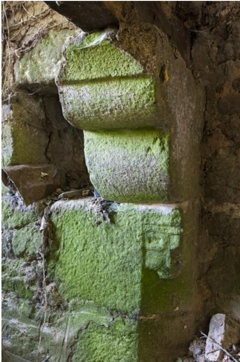
Cheminée sud de l'alignement sud, en ruines, détail du piédroit gauche.
