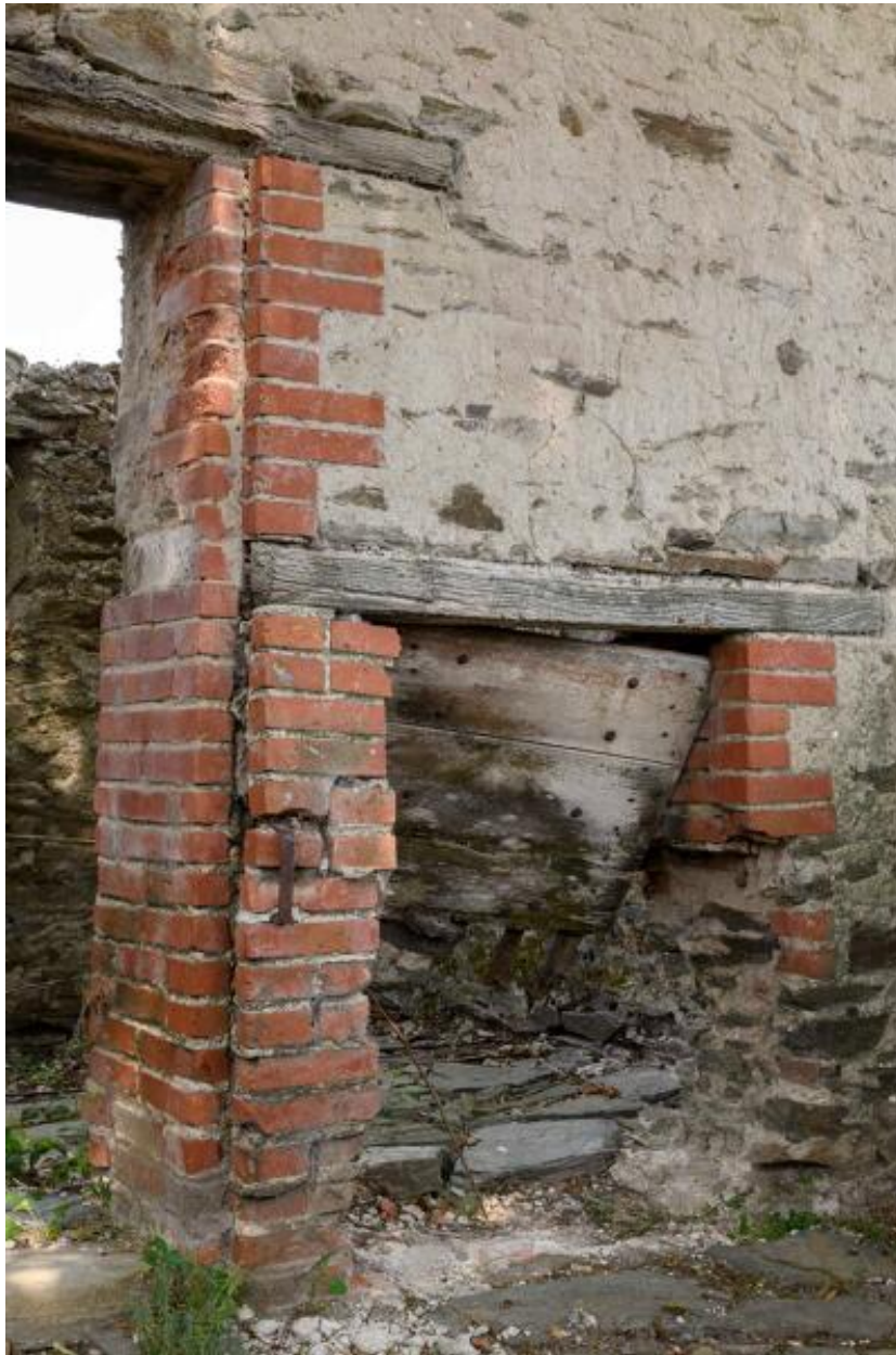
Détail d'une ouverture du toit à porcs de la Petite Touche Fleury.
