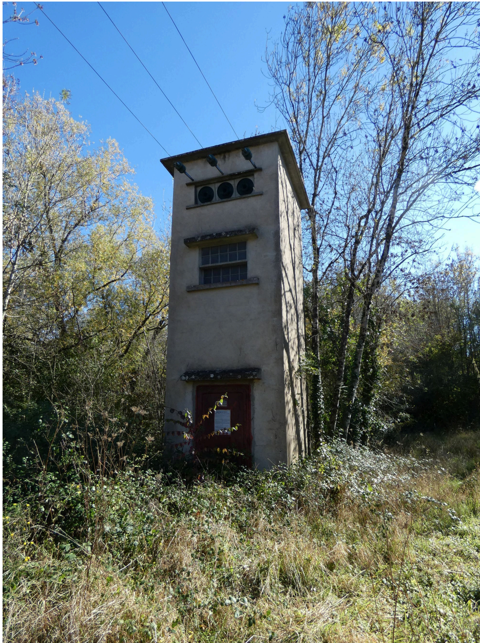
Le transformateur électrique vu depuis le nord.
