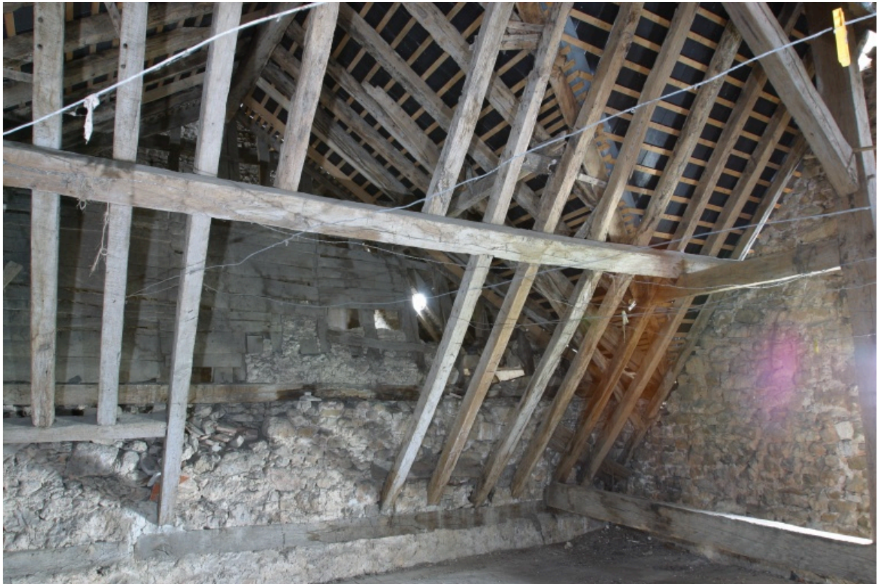
Comble du corps nord : les chevrons et la panne intermédiaire sud de la charpente.
