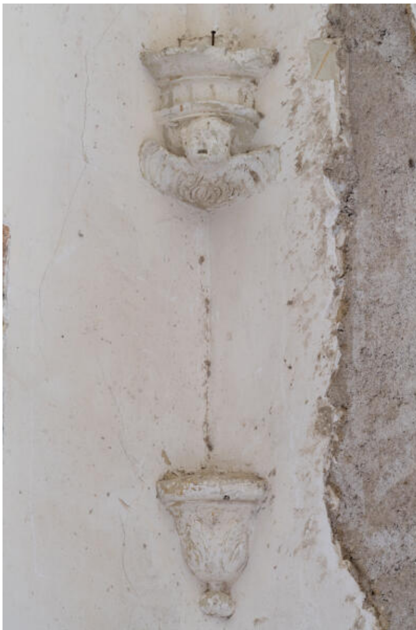
Chapelle latérale : retombée de voûte.
