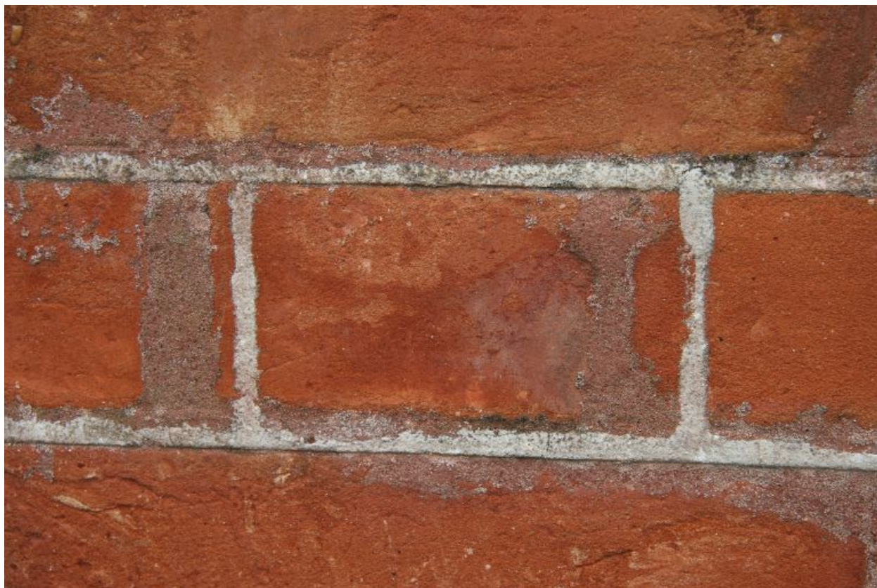
Faux joints dans un enduit fausse brique.
