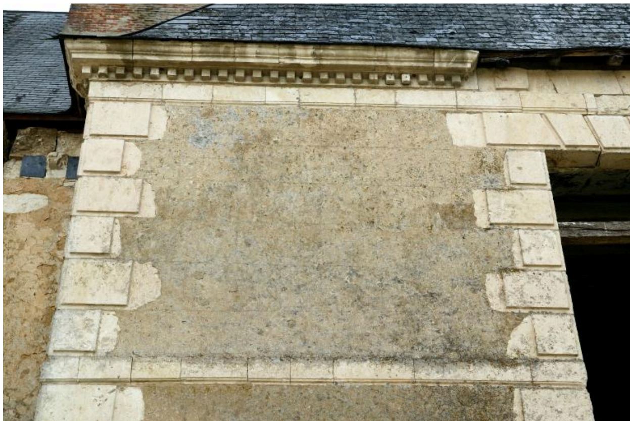
Pavillon du XVII e siècle, façade est : détail de l'enduit incisé pour imiter les joints de la pierre de taille.
