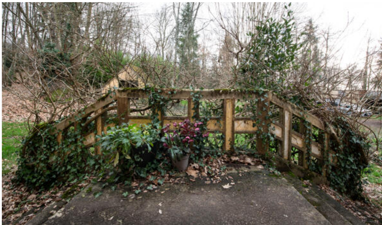
Garde-corps du perron.
