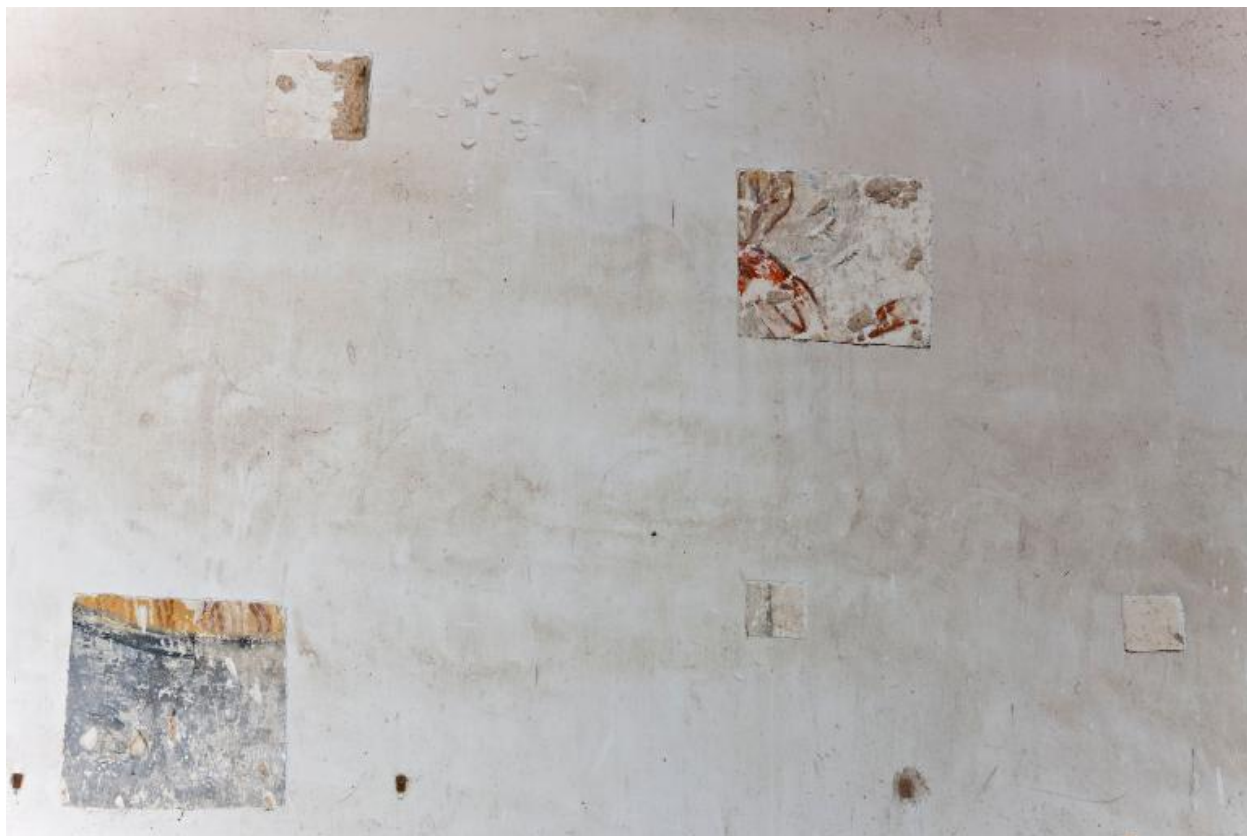
Chapelle de la Vierge, mur est, détail : peinture (18e s. ?) sous l'enduit.
