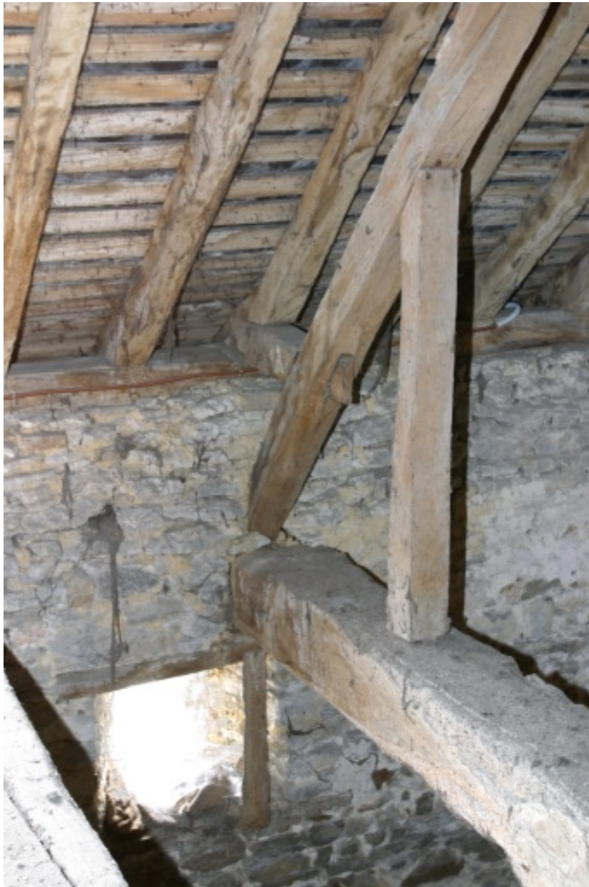
Comble de la dépendance contigüe au logis : vue de détail d'une ferme.
