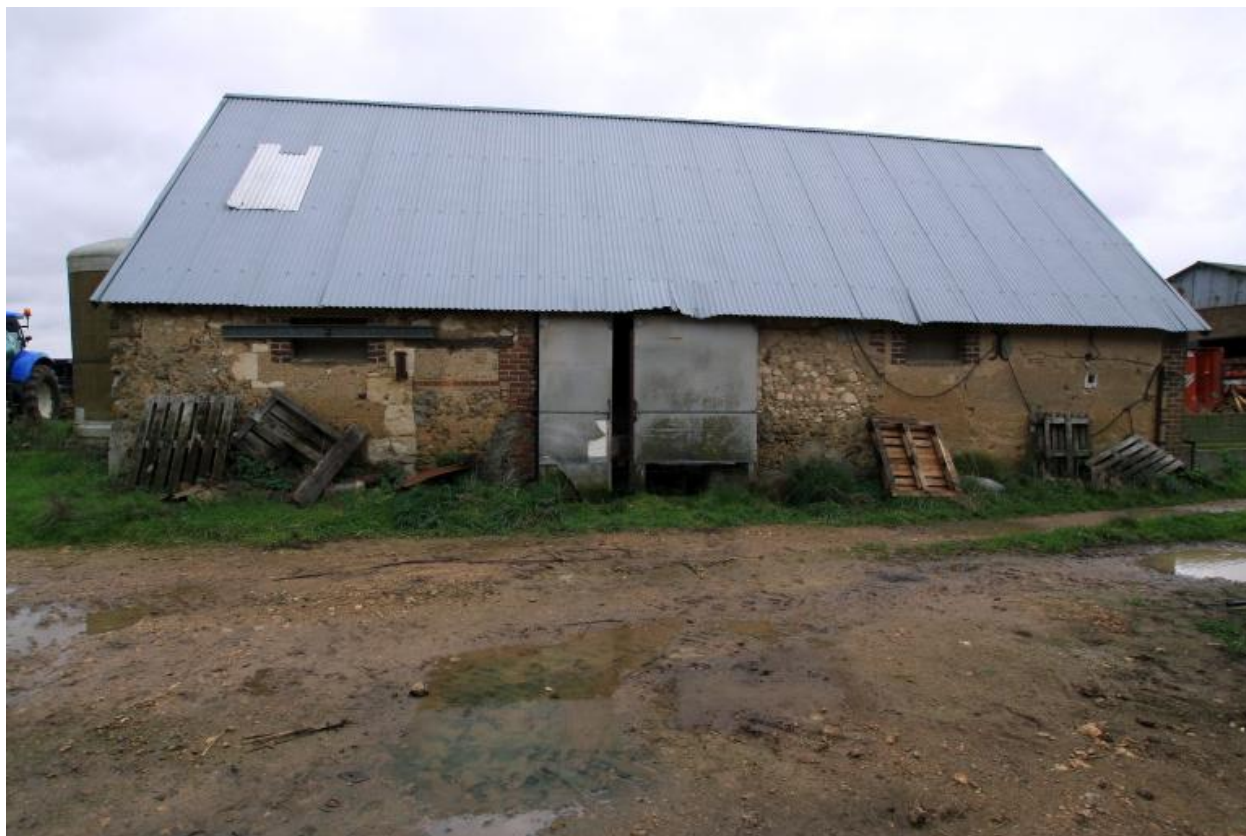
Etable 2 : façade antérieure très remaniée.
