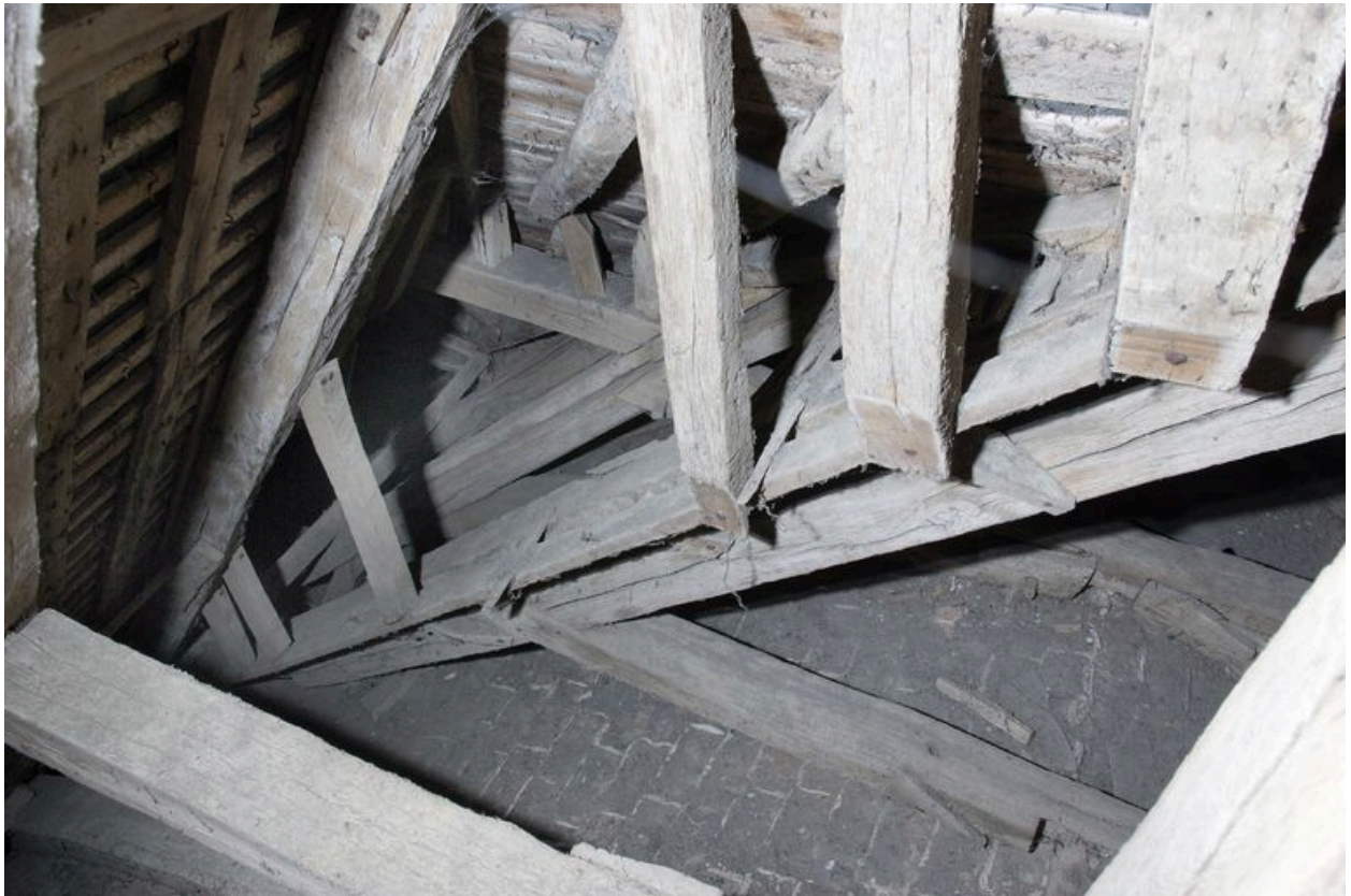
Charpente du choeur : parties nord des deux premières fermes vues depuis la charpente de la nef.
