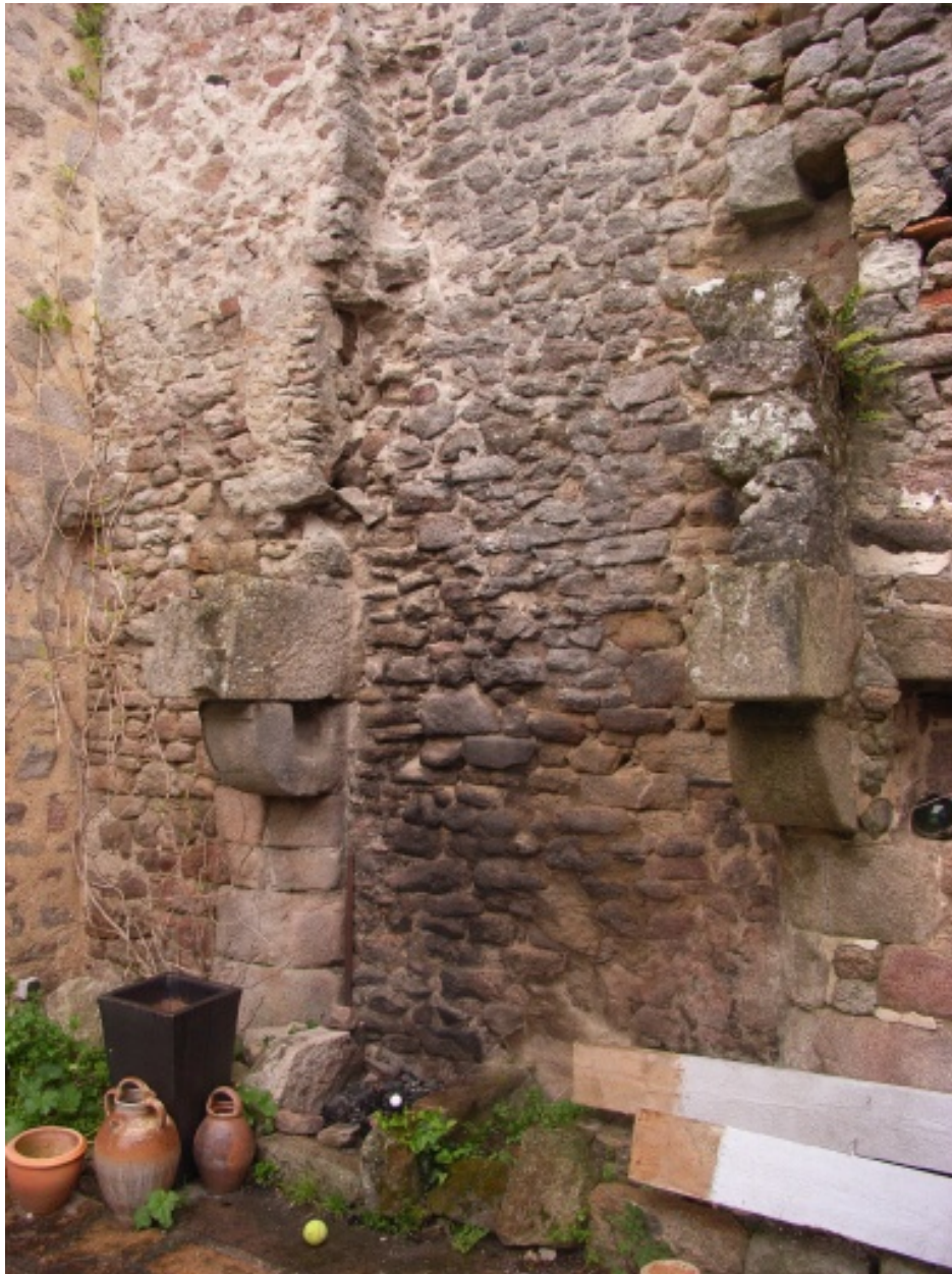
Vue de la cheminée détruite dans la cour.
