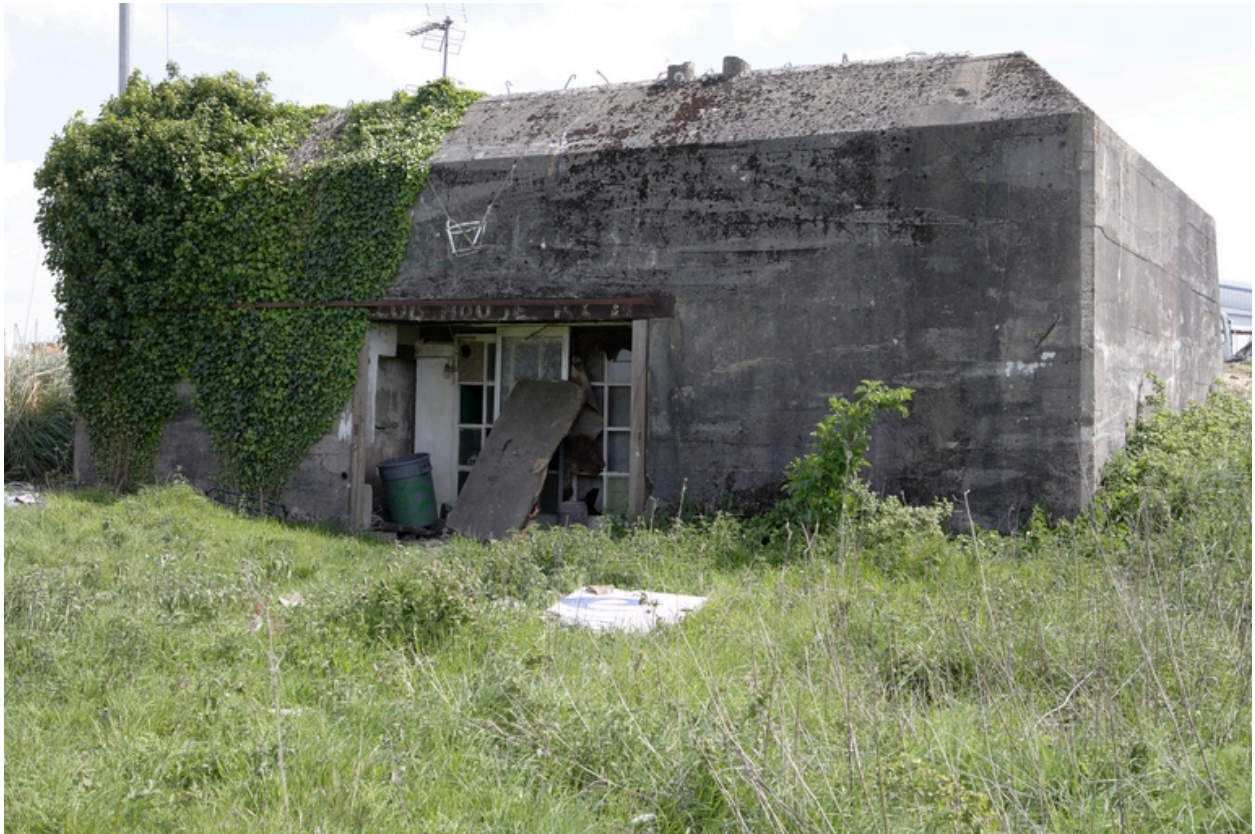
Villejames. Batterie secondaire 4/AR 275, dite Dora. Vue de la casemate n° 4, de type H 669.
