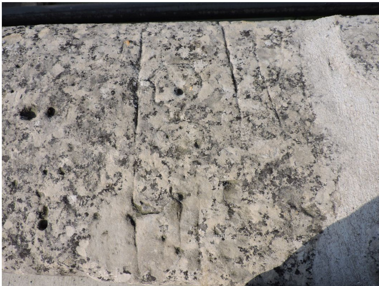
Graffiti sur le parapet aval : personnage.
