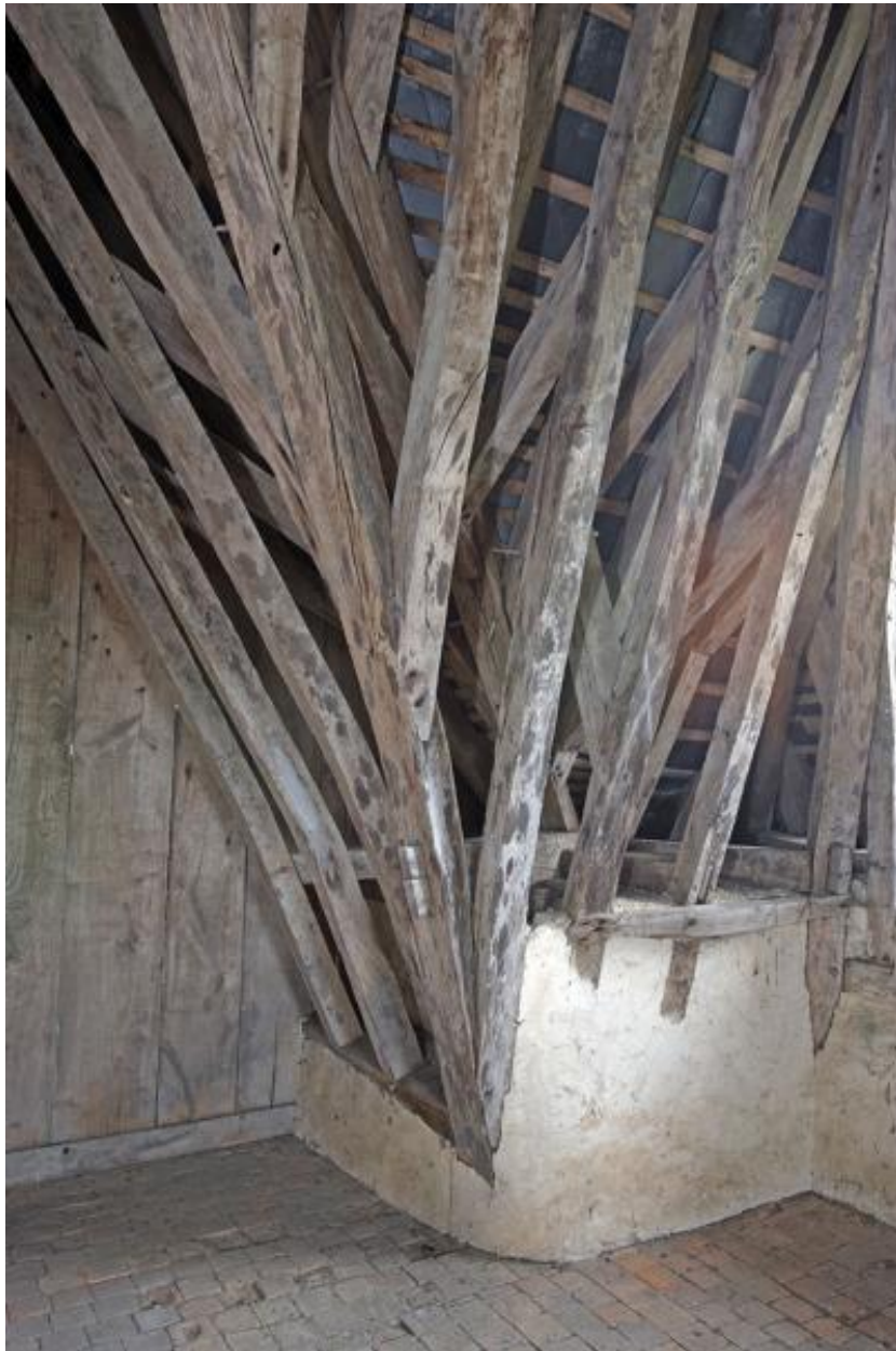
Le grand comble et sa charpente, croupe du pavillon nord, détail des chevrons.
