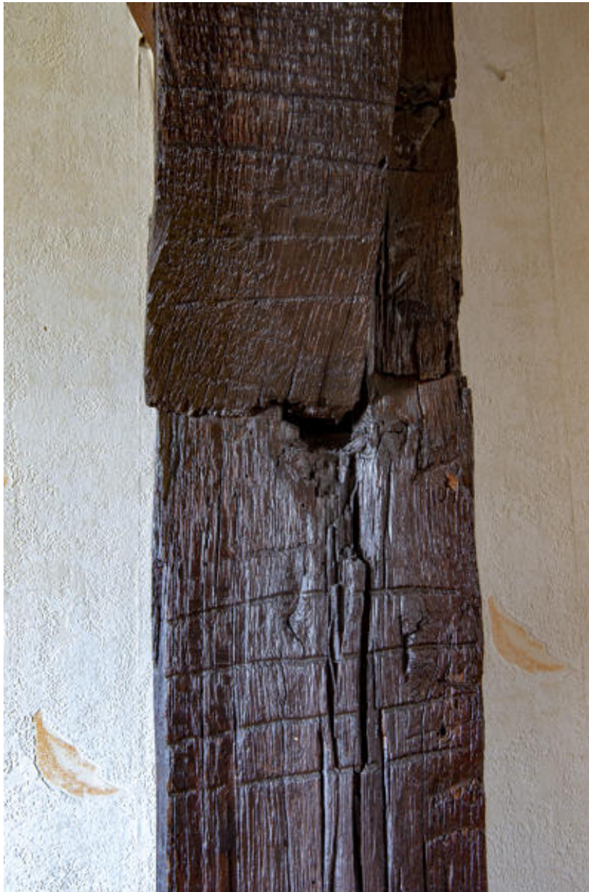
Vue des marques de charpente sur le poteau pris en maçonnerie.
