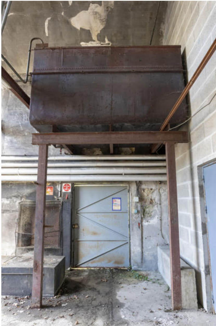
Vue du réservoir d'eau de la chaufferie.
