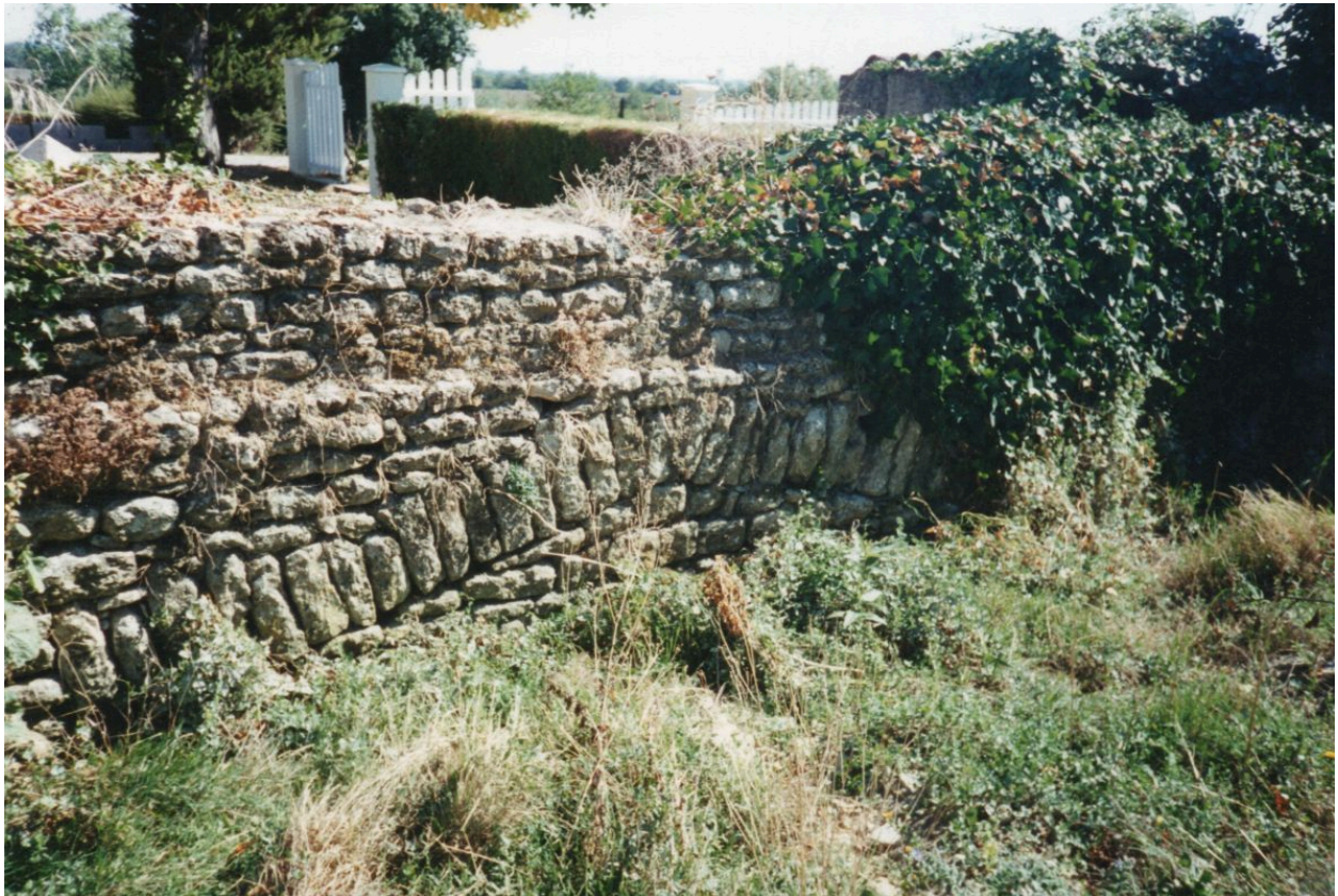
Partie du mur de clôture du jardin, côté nord-est, avec arc de décharge.
