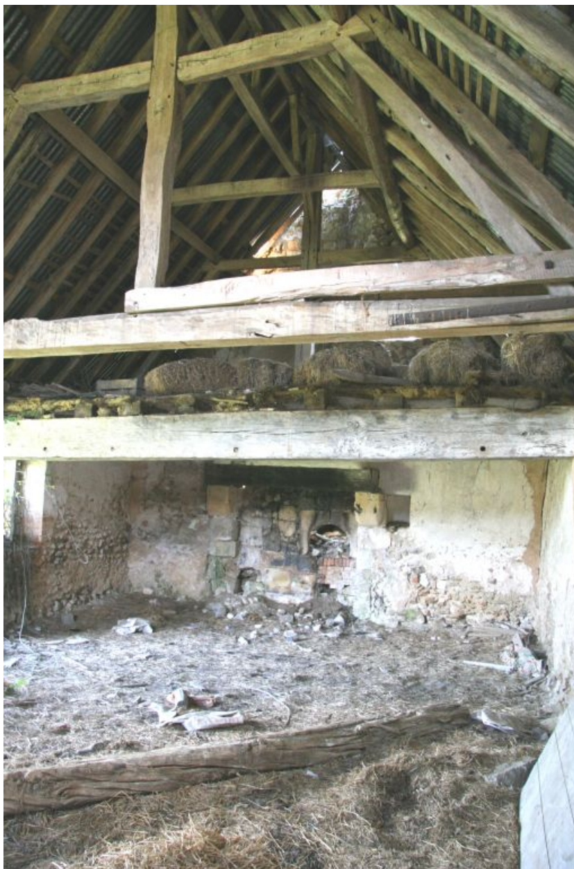
Vue d'ensemble de l'intérieur : plafond en partie détruit.
