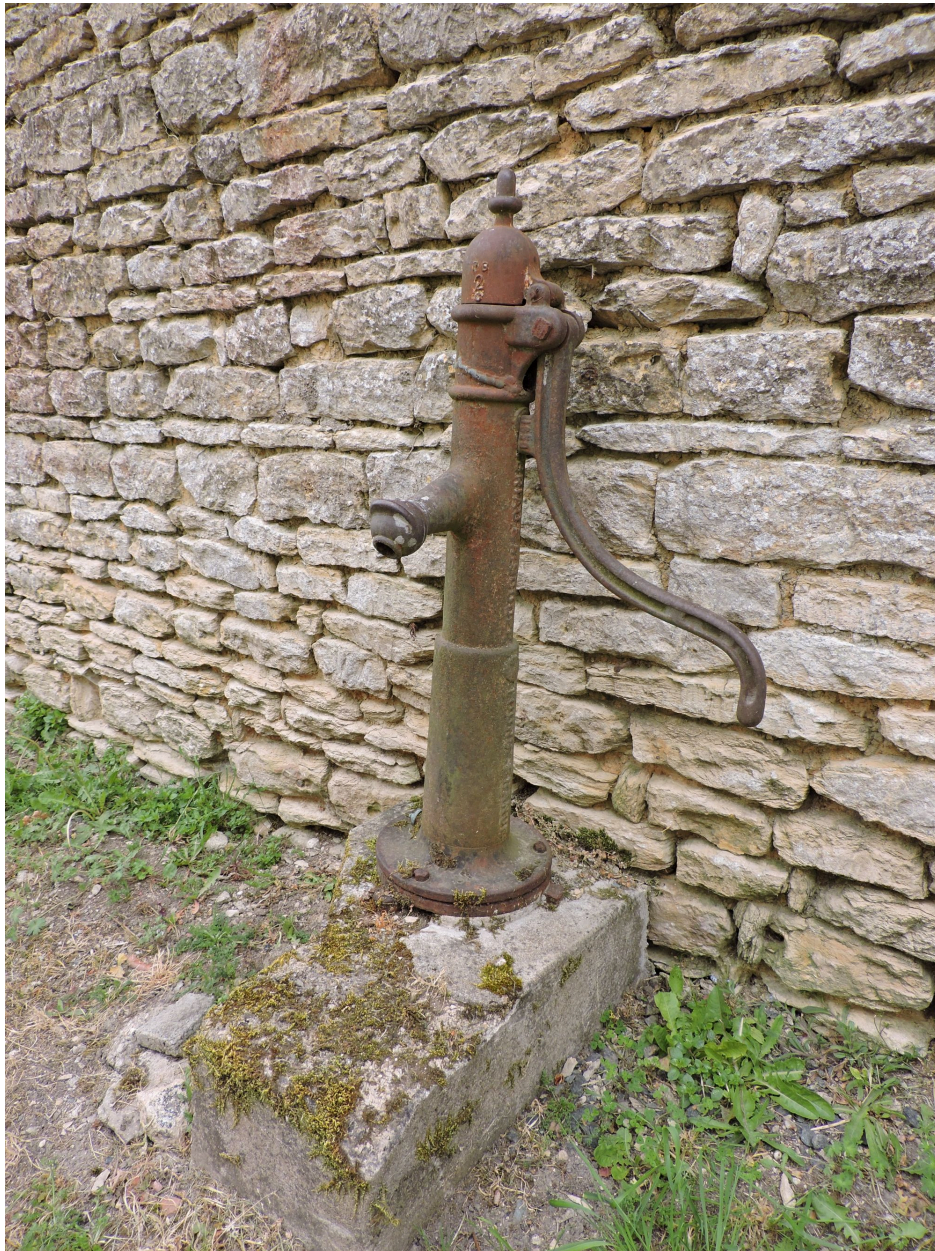
Le puits et sa pompe, à l'est de l'impasse.
