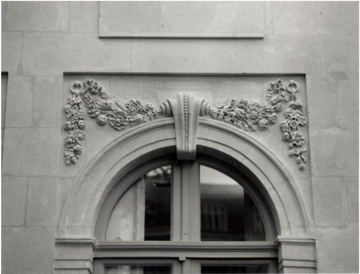
Elévation latérale sur l'ancien jardin : partie supérieure de la porte-fenêtre centrale du grand salon, après restauration.
