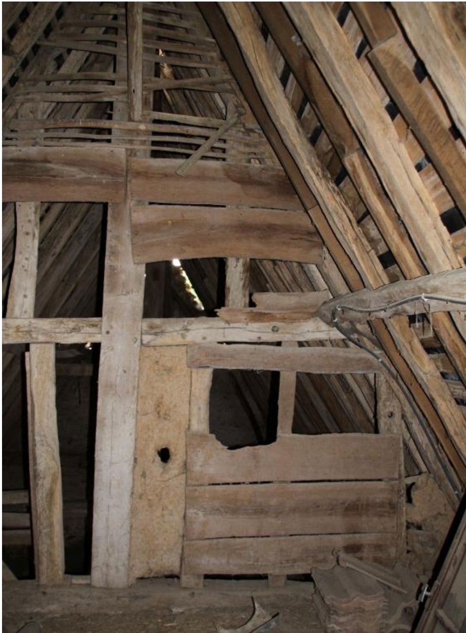
Comble : détail de la cloison à pan de bois du pignon entre la maison et la grange, côté ouest.
