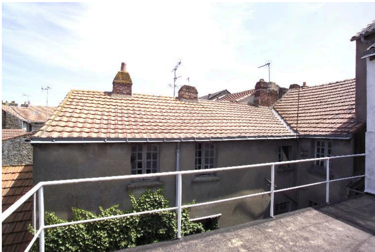
L'ensemble de la couverture vue de la terrasse de la maison n° 32.
