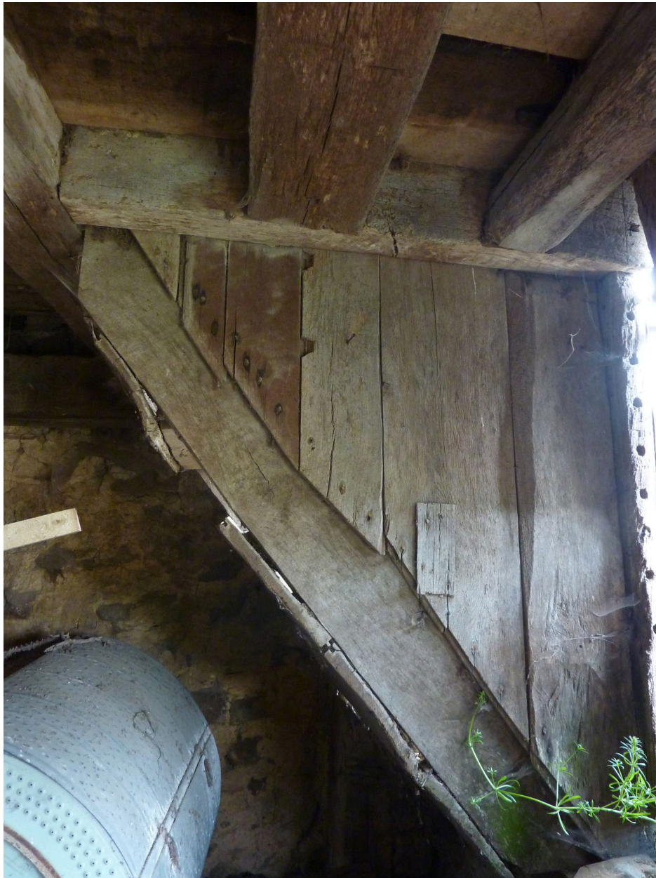
L'escalier vers le comble, vu depuis le logement ou fournil (état en 2003).
