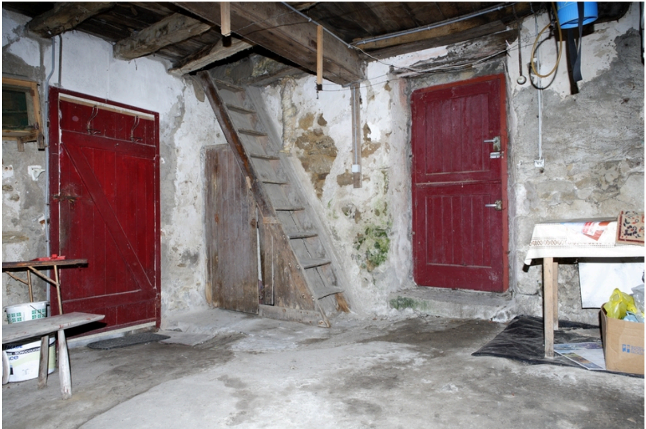
Détail de l'échelle de meunier menant au comble du n° 9 rue du Rocher.
