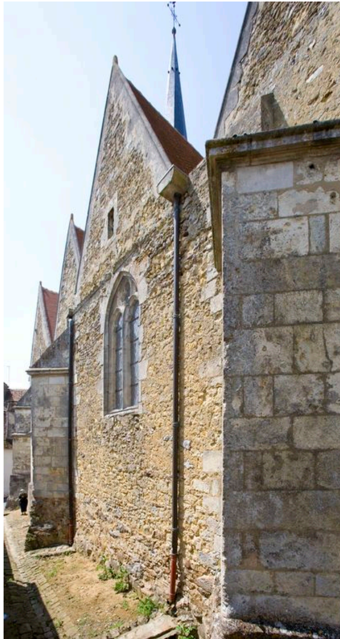
3e travée du bas-côté sud : 1er niveau d'élévation de la tour détruite
