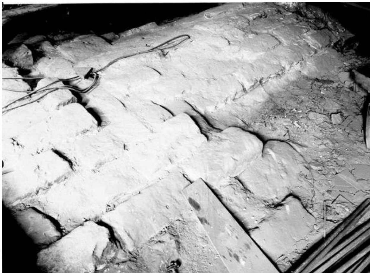
Aile sud de l'abbaye, escalier d'honneur, voûte principale : détail de l'extrados, angle nord-est
