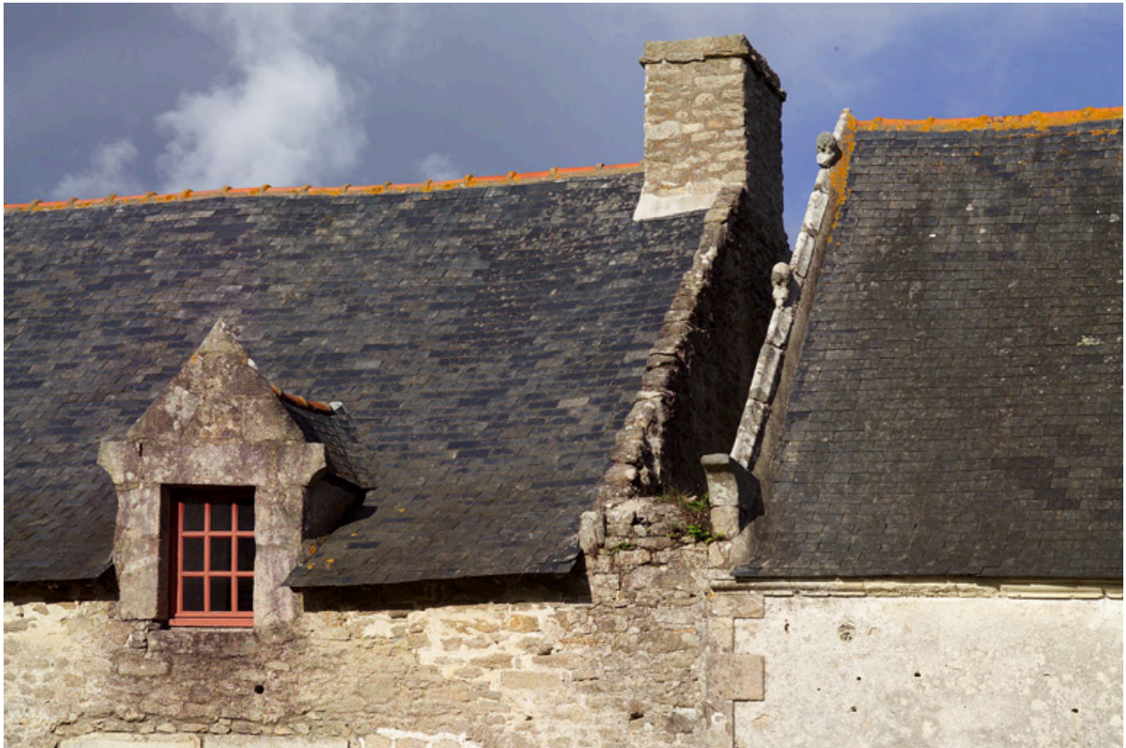
Raccord des toitures de la chapelle et du premier corps de communs.
