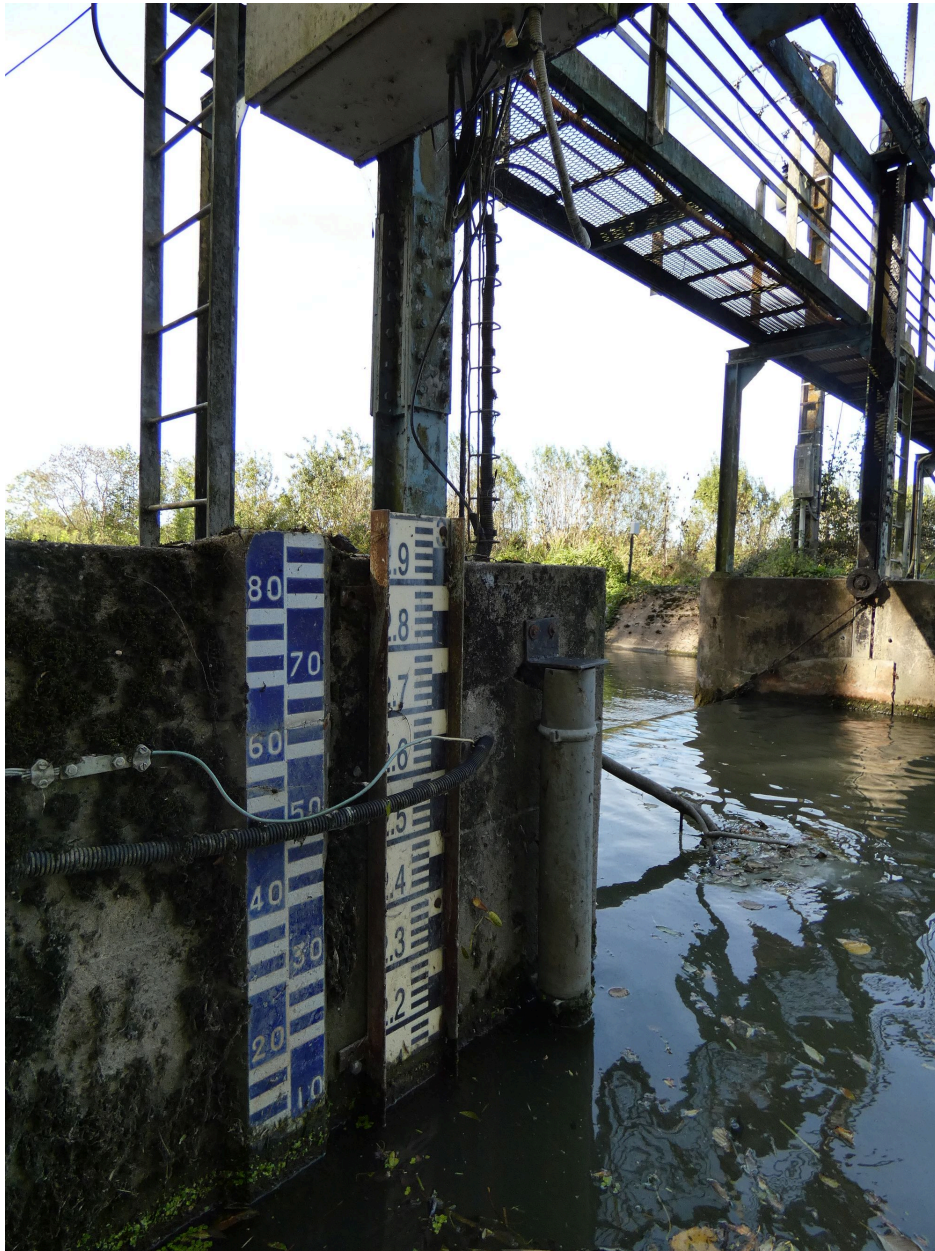
Règles de mesure du niveau d'eau sur la culée gauche du barrage, côté amont.
