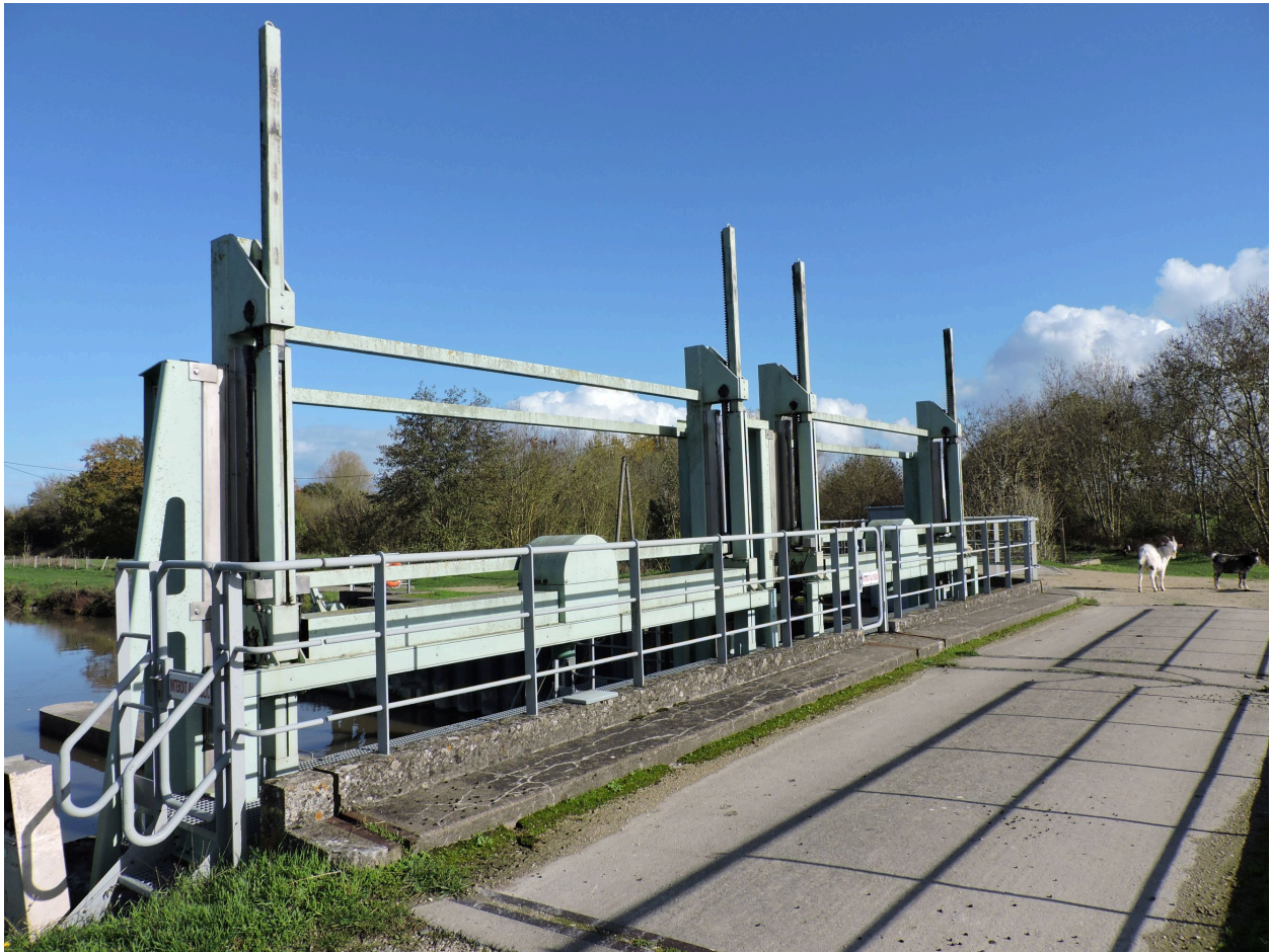
Les deux portiques du barrage au-dessus du second aqueduc, vus depuis le sud-ouest.
