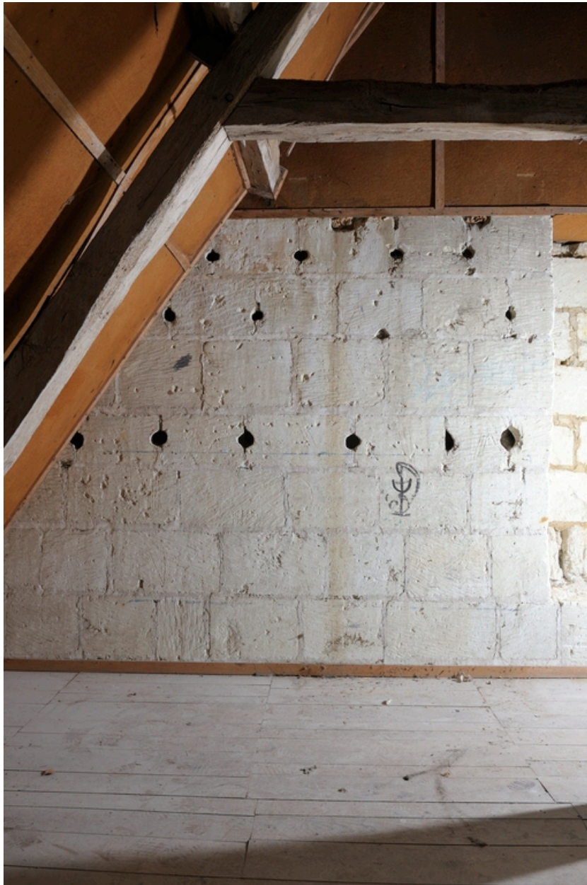
Ancienne chapelle nord (fin XVe siècle), comble, mur sud. Trous de boulin d'un pignonier de la seconde moitié du XVe siècle.
