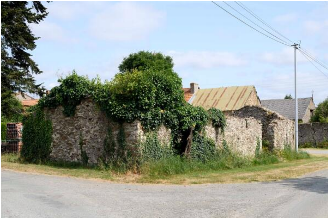
Edifice agricole en ruine situé au sud des logis du Plessis Pasquier.
