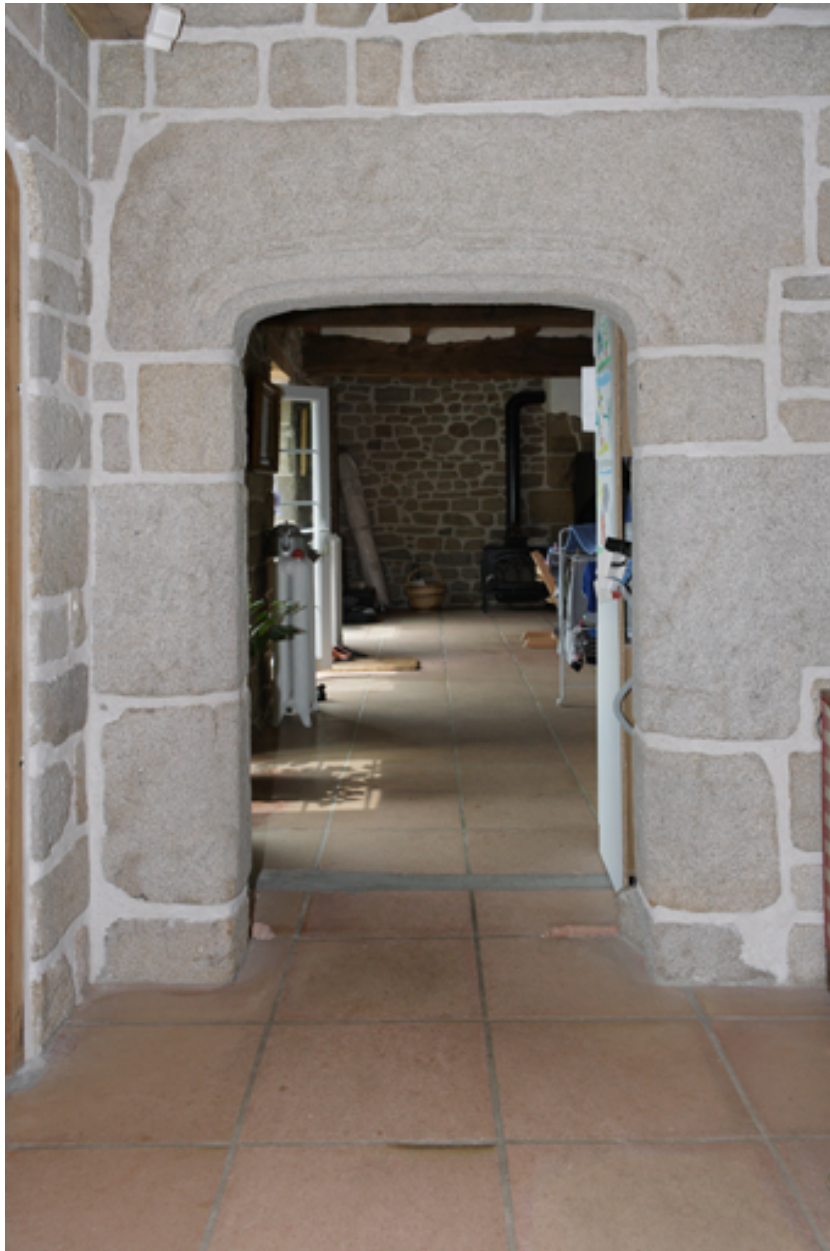
Logis Aile nord-ouest. Détail de la porte sur le mur de refend.
