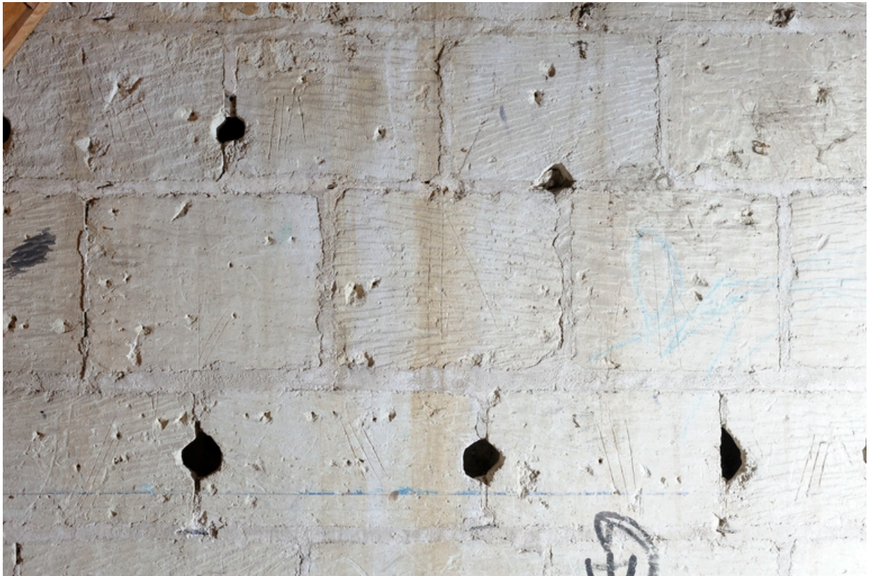
Ancienne chapelle nord (fin XVe siècle), comble, mur sud. Trous de boulin, percés dans les joints de l'appareil de tuffeau.
