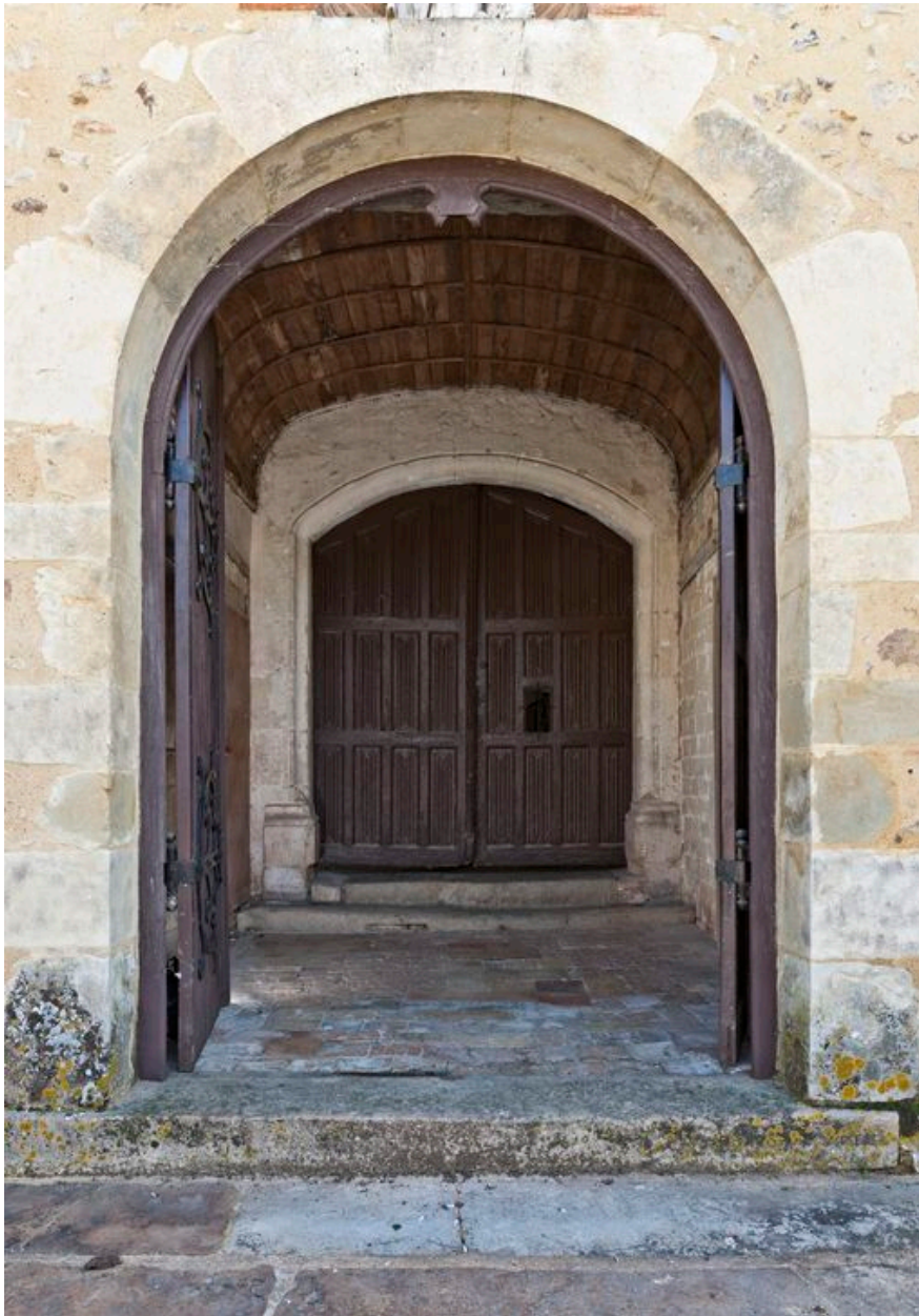
Le couloir distribuant l'avant-corps et la nef. Au premier plan, le portail refait en 1853.
