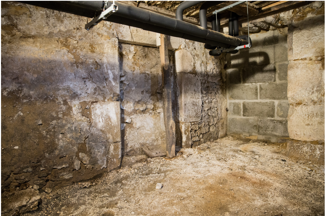
Les caves de l'ancienne gendarmerie, les portes murées.
